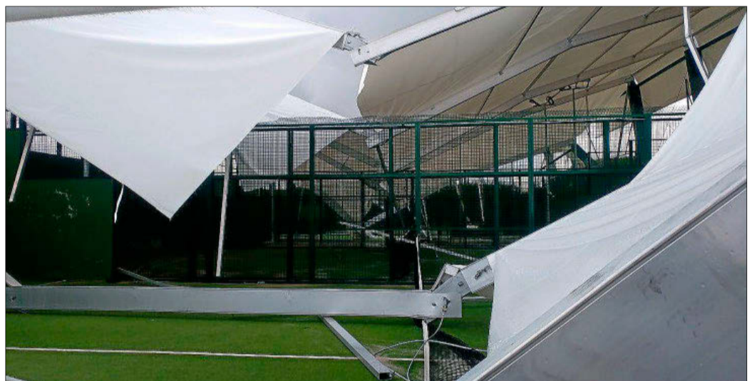
Pista de pádel de Aldeamayor Golf tras el hundimiento de la cubierta recién instalada, ayer. EL MUNDO
